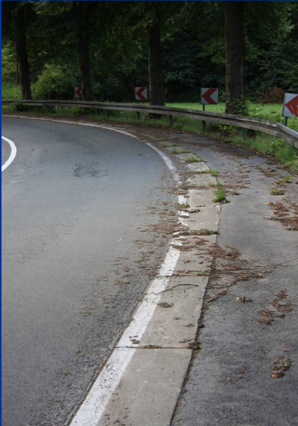
Verschmutzung, Spurrinnen, Oberflächenschäden
