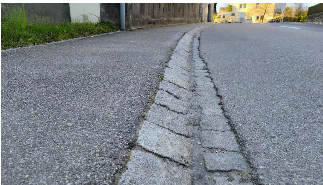
Abbildung 7: Ungünstig gestalteter, zu steiler Bordstein zwischen Fahrbahn und Gehweg (Schweiz)
